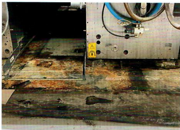
Bild 2: Extreme Verschmutzungen mit Korrosionsprodukten unterhalb der Druckwerke
